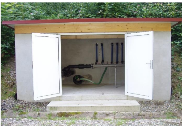
Gashaus mit Gassammelbalken
